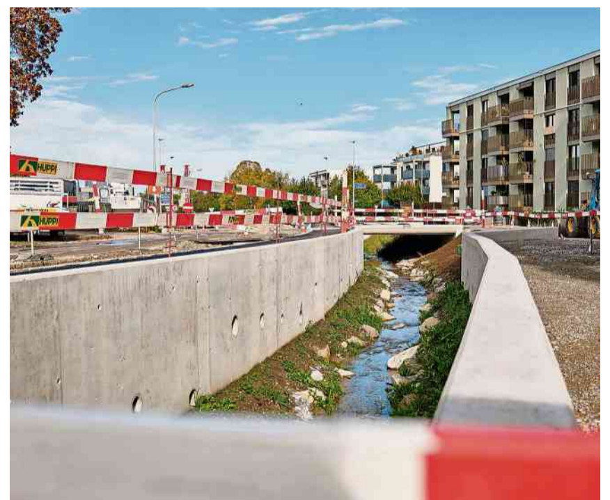
Auch in einem Betonkanal kann viel für die Natur gemacht werden.
