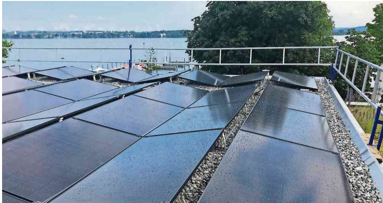
Seit Mitte Juni liefern 72 PV-Module Energie für das Restaurant Fischerhaus.
