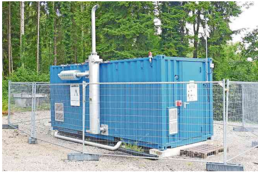
Um die Spaziergängerinnen und Spaziergänger über die Sanierung der Altdeponie zu informieren, wurde eine entsprechende Informationstafel beim Anlagencontainer installiert.
